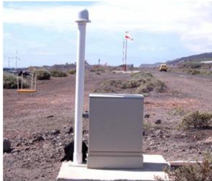
Detector de tormenta eléctrica
